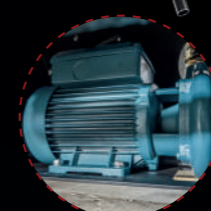
PUMP: Pompa di scarico esterna
