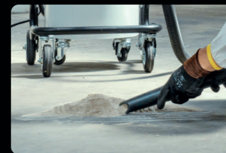
Extraction des poussières fines
